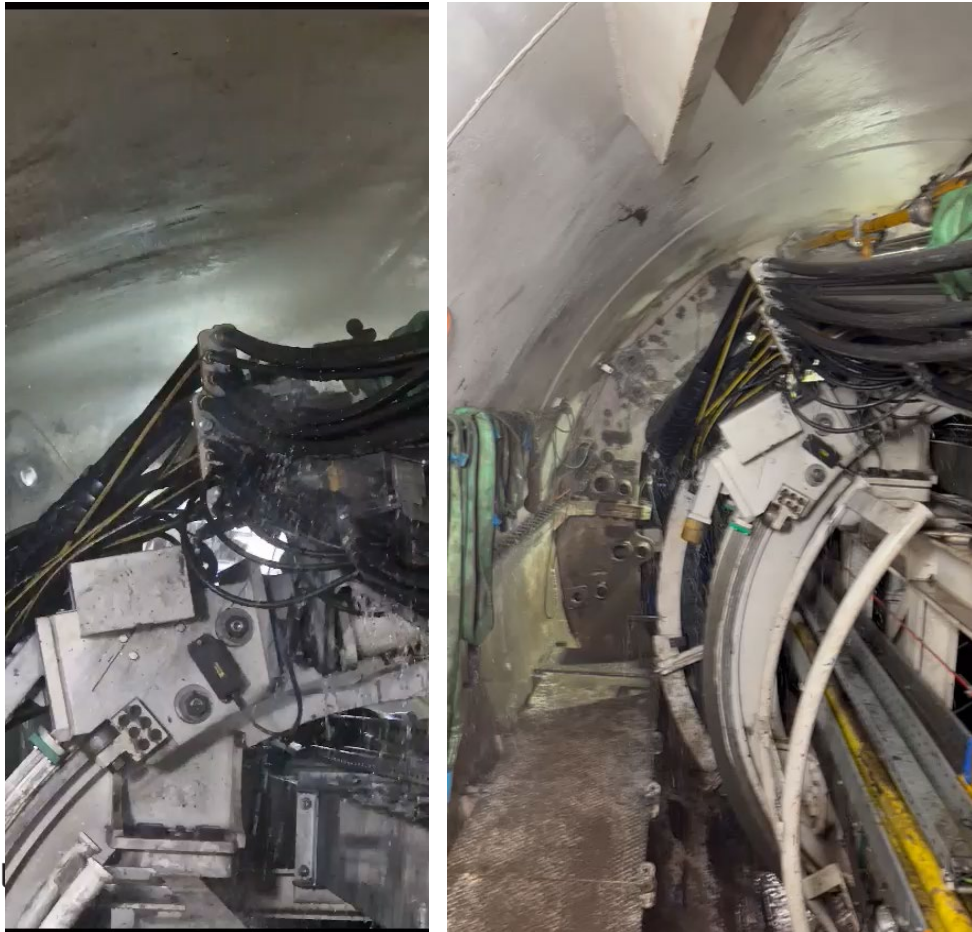
Innlekkasje fra borehull
