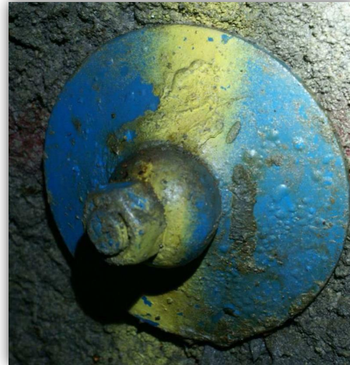
Sandsynlig svikt i vedheft mellom epoxy og zink, forbehandling?. Foto: Norconsult, Oslofjordtunnelen
